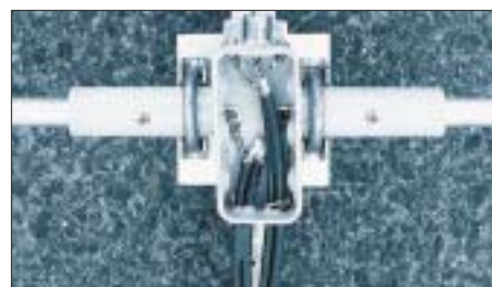
Bild 4: Blick in die Anschlußdose mit den angeschlossenen Anpaßleitungen
